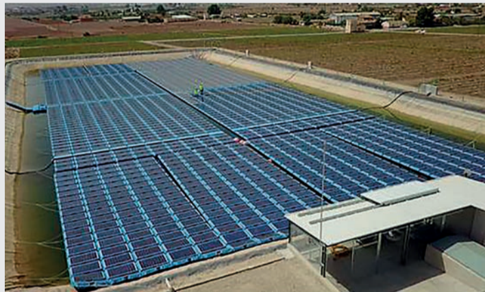
Sistema generador fotovoltaico flotante en balsa de riego. CR de Lorca. / FERROVIAL
