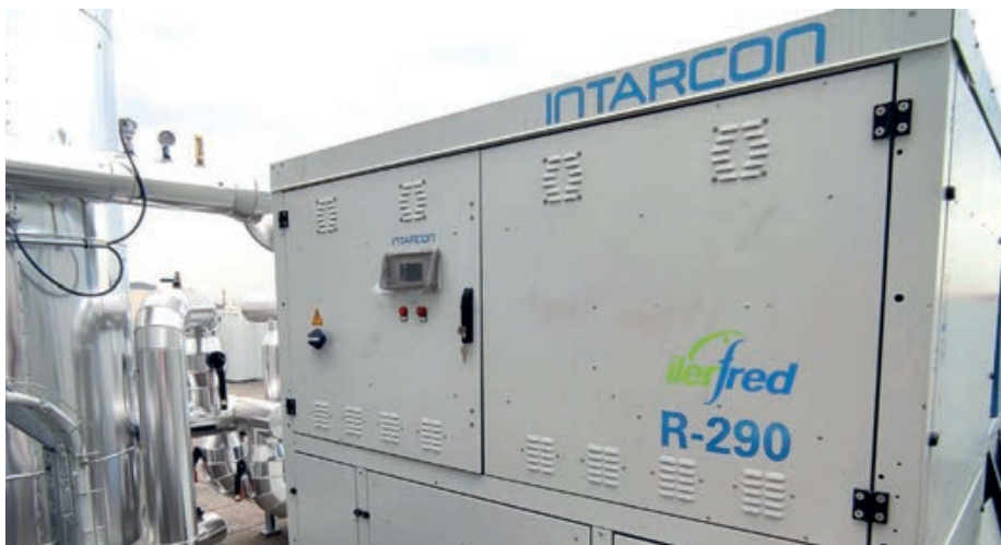
La instalación frigorífica moderna busca la eficiencia y la responsabilidad medioambiental. / ILERFRED
