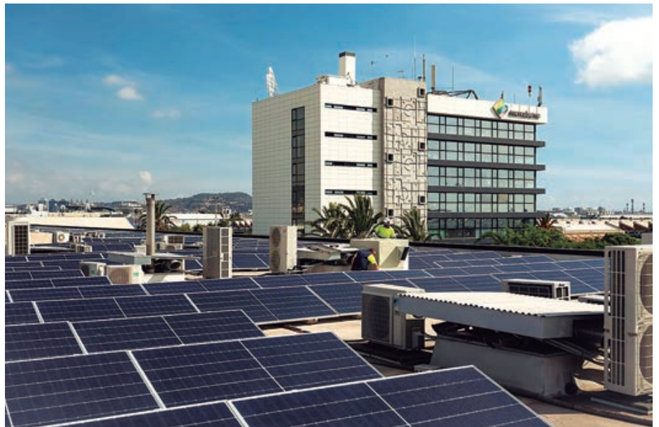
El proyecto de energía fotovoltaica cubrirá el 25% de las necesidades energéticas de la unidad. / MB
