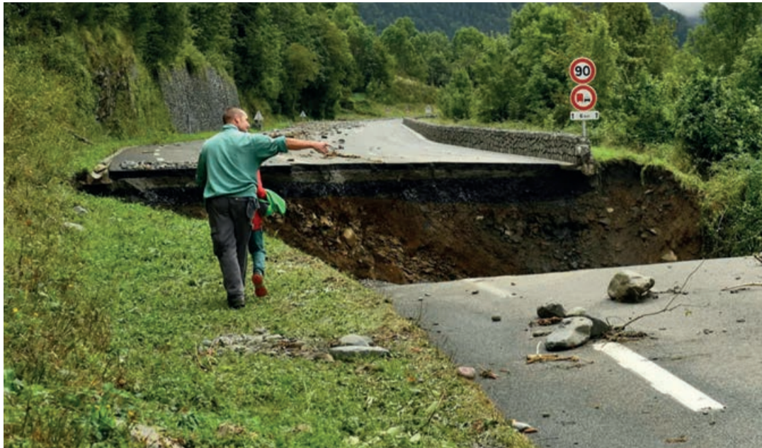
Carretera de un paso fronterizo por el Pirineo aragonés cortada por un corrimiento a raíz de las fuertes tormentas. / JO
