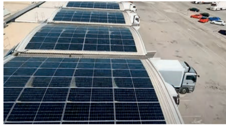
El mercado ha instalado paneles solares en sus instalaciones. / MERCOVASA
