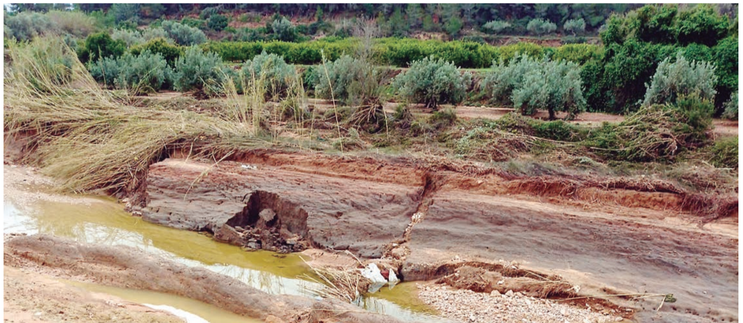
En algunos casos los daños llegan al 80% del valor de las infraestructuras de las comunidades de regantes. / VALENCIA FRUITS
