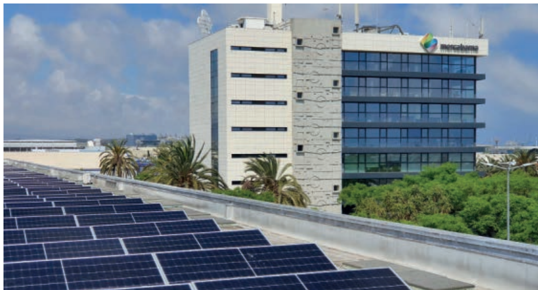
Una imagen de las placas fotovoltaicas instaladas en las cubiertas. / MERCABARNA
