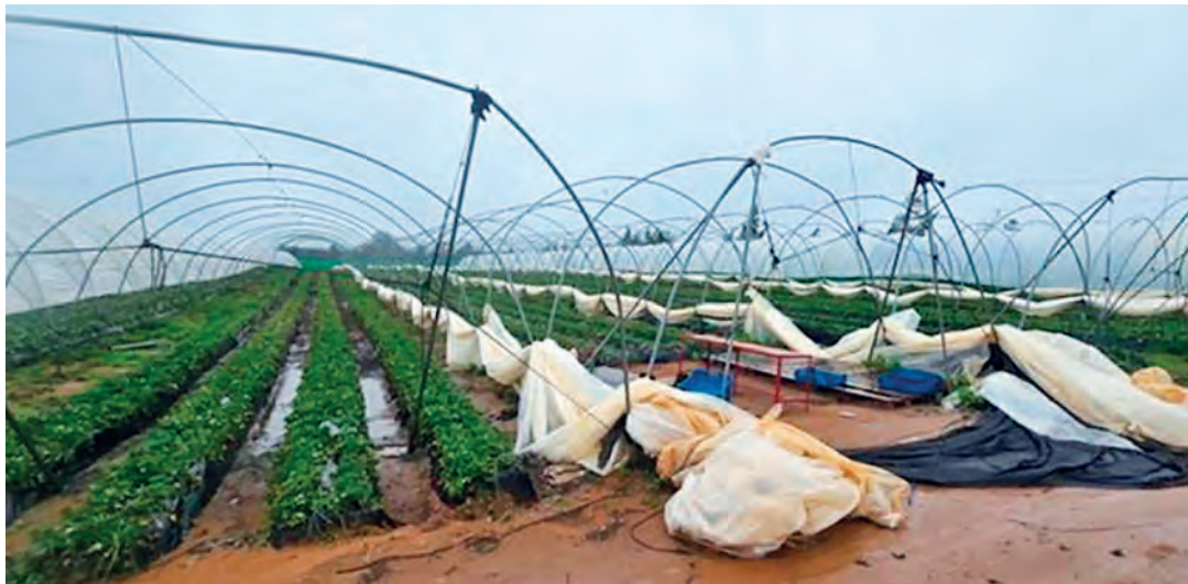
Invernaderos de fresa que presentan daños estructurales y de cubierta. / IFAPA
